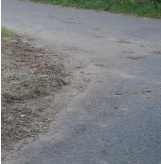
Abb. 16: Verschmutzung im Kurvenbereich bedingt Sturzgefahr
